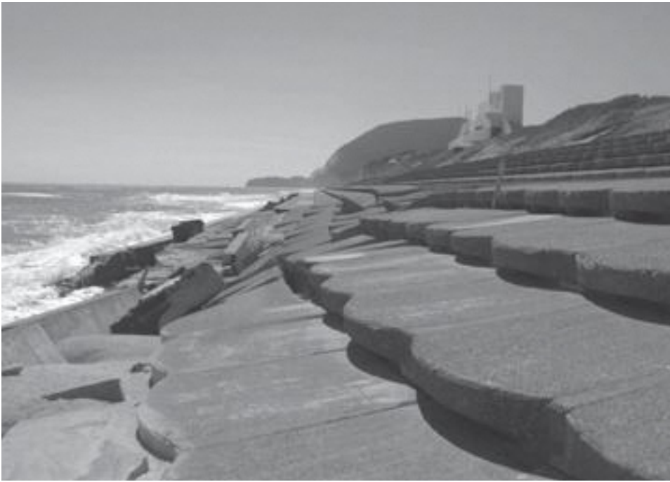
羽伏浦メインゲート前の護岸。浸食がひどい。
